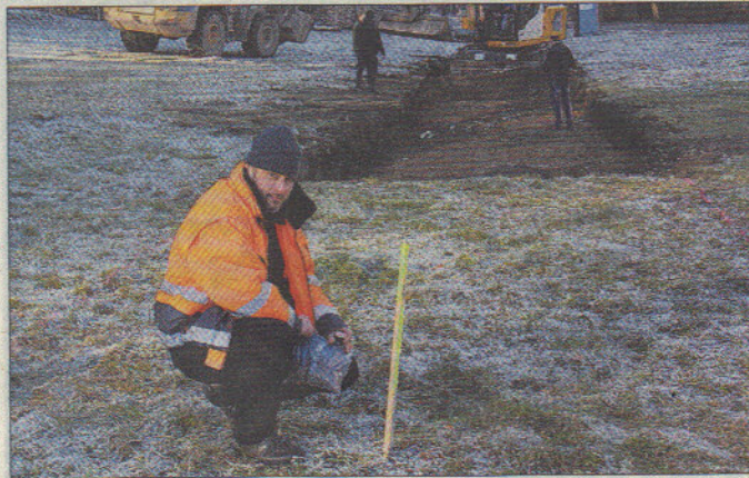
Geologe Jens Ulrich entnimmt in unmittelbarer Nähe des Ansatzpunktes für die Schachtteufe eine Bodenprobe. Der Erkundungsschacht geht in eine Tiefe von 175 Meter und steht dann auf Erz. Foto: H.-J. Schwochow
