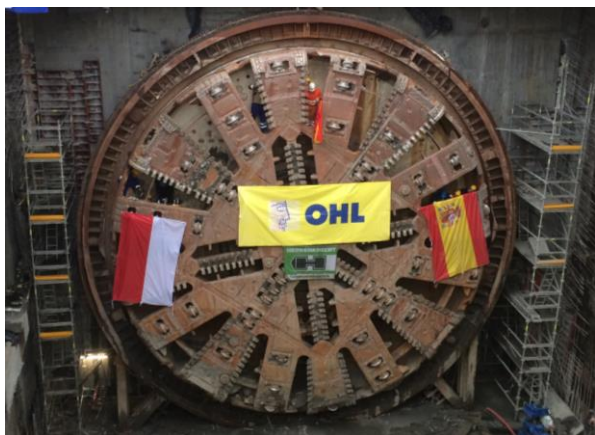
Bild2: Der Durchbruch der ersten Röhre erfolgte im November 2013. Der finale Durchstich gelang im Juni 2014.
